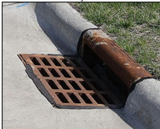
Figura 90. Boca de lobo com gradeamento na sarjeta
