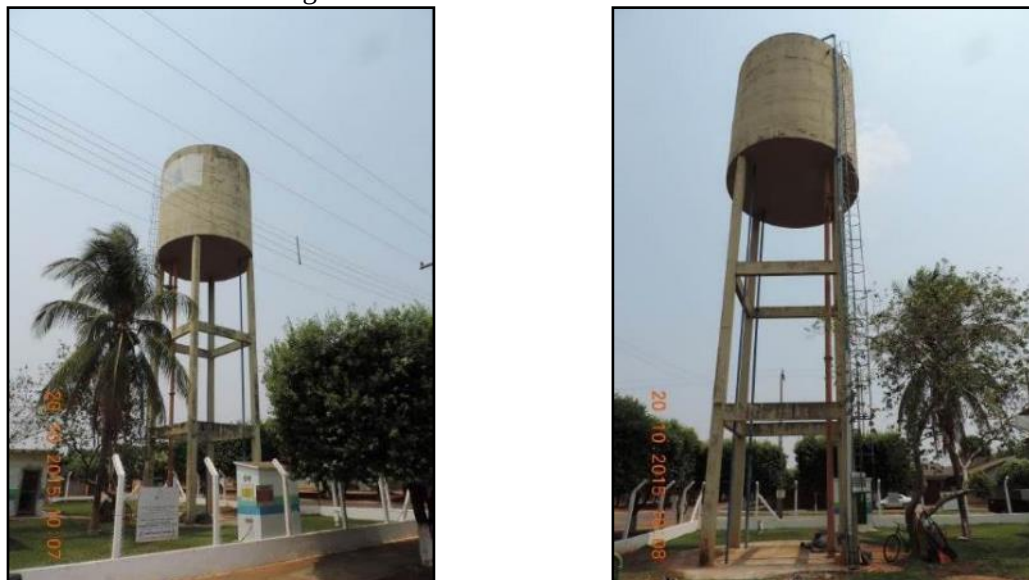
Figura 12. Reservatório elevado - 150 m 3
