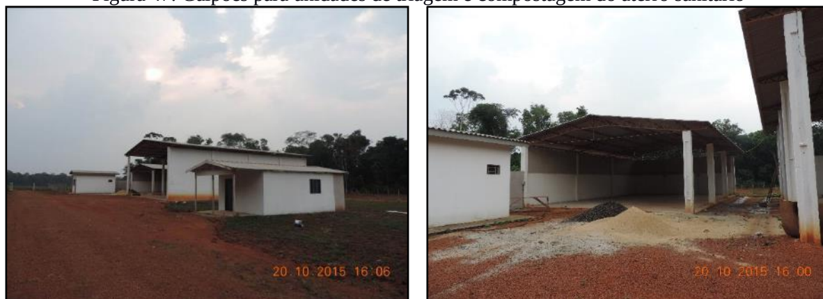
Figura 47. Galpões para unidades de triagem e compostagem do aterro sanitário
