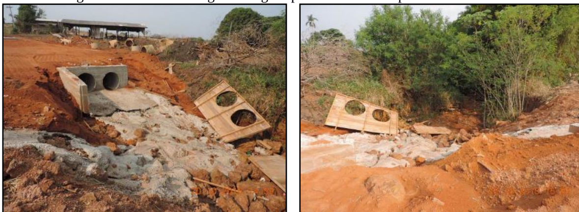
Figura 37. Ponto de deságue das águas pluviais do município de Santa Carmem
