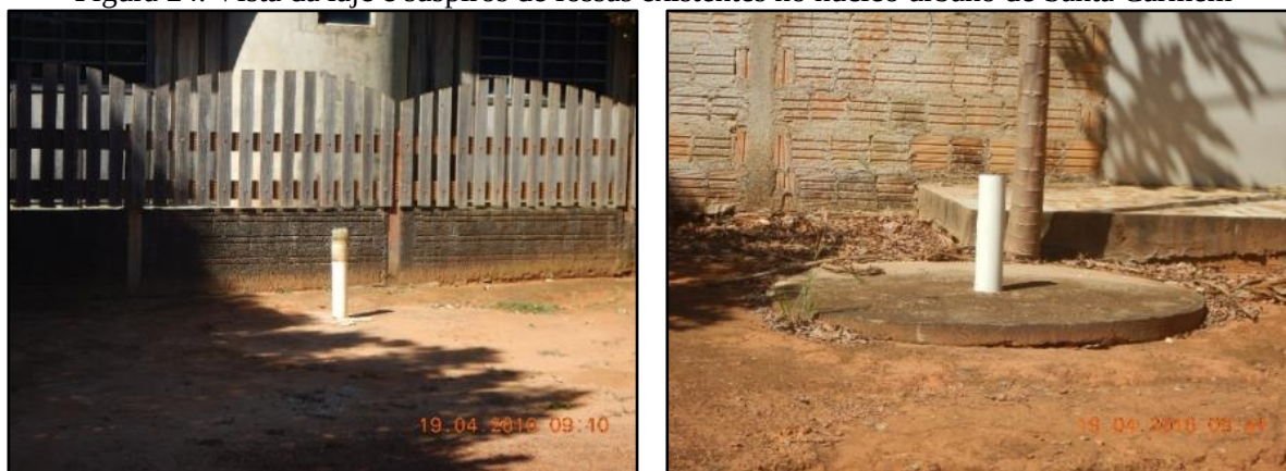
Figura 24. Vista da laje e suspiros de fossas existentes no núcleo urbano de Santa Carmem
