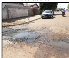
Figura 1467. Esgoto a céu aberto
