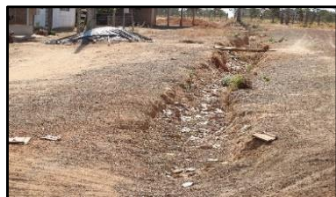
Figura 1472. Erosão em via pública
