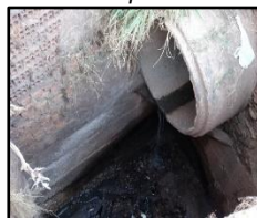
Figura 1494. Ligação clandestina na rede pluvial
