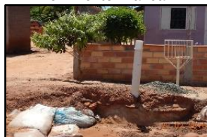
Figura 1528. Fossa instalada em Ponte Branca
