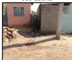
Figura 1468. Esgoto a céu aberto
