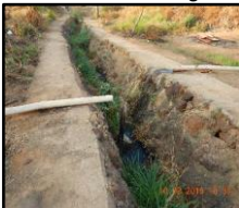
Figura 1570. Ligação clandestina de esgoto
