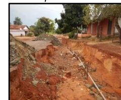
Figura 1535. Erosão acentuada com ravina em via pavimentada
