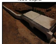
Figura 1577. Boca de erosão
