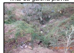
Figura 1578. Erosão no final da galeria pluvial
