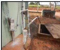
Figura 1525. Sistema de cloração utilizado
