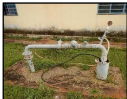
Figura 1524. Poço tubular PT-01
