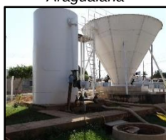
Figura 1464. ETA de Araguaiana
