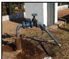
Figura 1482. Captação subterrânea PT-03
