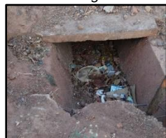
Figura 1492. Presença de lixo em dispositivo de drenagem
