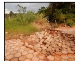
Figura 1536. Pavimento danificado em via pública
