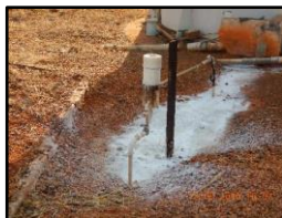
Figura 1544. Clorador de contato
