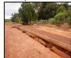
Figura 1534. Erosão acentuada com ravina em via pavimentada
