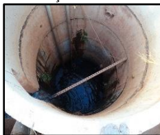
Figura 1487. Poço de sucção da EEE
