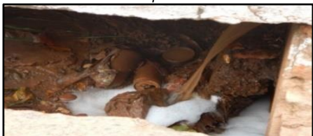
Figura 1508. Ligação clandestina de esgoto na rede pluvial
