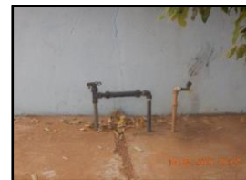
Figura 1546. Ligação domiciliar não hidrometrada
