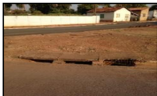
Figura 1512. Boca de lobo tripla danificada
