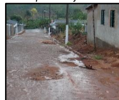
Figura 1495. Escoamento de água pela sarjeta
