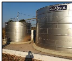
Figura 1489. Reator aeróbio e decantador
