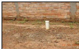
Figura 1529. Fossa instalada em Ponte Branca
