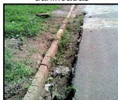
Figura 1446. Via e sarjeta danificadas
