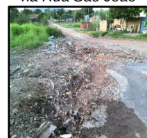
Figura 1364. Erosão na Rua São João
