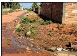
Figura 1356. Escoamento de esgoto a céu aberto na rua
