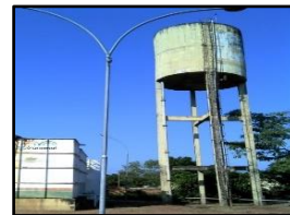
Figura 1438. Reservatório REL-01 na ETA
