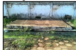
Figura 1443. Escoamento de esgoto a céu aberto
