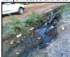
Figura 1357. Esgoto misturado à água de lençol freático aflorante
