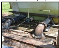
Figura 1412. Poço de sucção na captação
