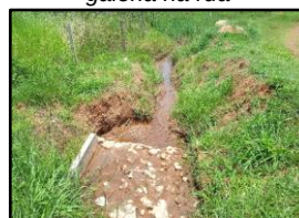
Figura 1343. Erosão formada no deságue da galeria na rua
