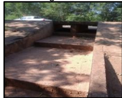
Figura 1383. Dissipador de energia existente
