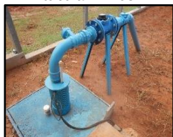
Figura 1293. Poço tubular PT-05
