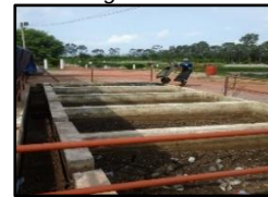
Figura 1381. Tanque de secagem do lodo
