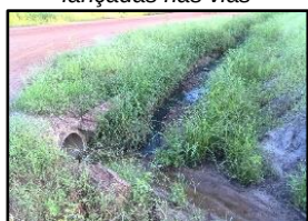
Figura 1360. Águas servidas lançadas nas vias
