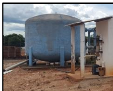
Figura 1332. Filtro da ETA
