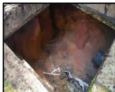
Figura 1331. Tanque de acumulação de água da mina
