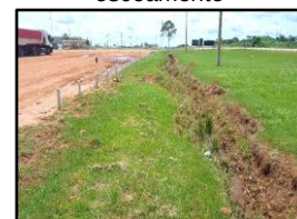
Figura 1344. Erosão formada no canal de escoamento
