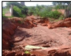
Figura 1386. Erosão em via não pavimentada
