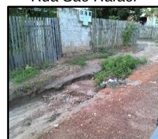
Figura 1363. Erosão na Rua São Rafael
