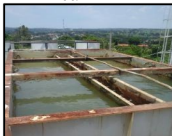
Figura 1414. Decantador da ETA
