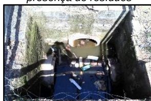
Figura 1362. Boca de lobo com presença de resíduos
