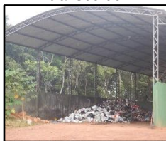
Figura 1306. Estação de transbordo
