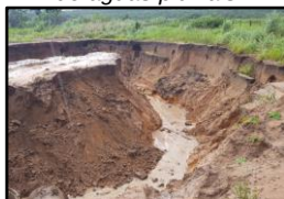
Figura 1321. Processo erosivo em ponto de deságue de águas pluviais
