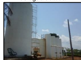
Figura 1416. Reservatório de água tratada
