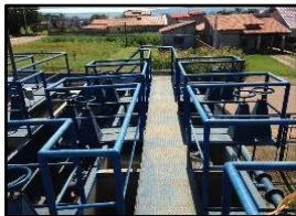
Figura 1351. Floculador da ETA
