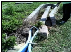
Figura 1441. Calha Parshall danificada
