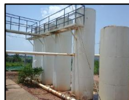
Figura 1415. Filtros da ETA
