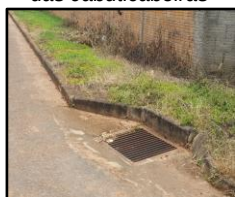
Figura 1340. Boca de lobo com grelha na Rua das Jabuticabeiras
