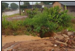
Figura 1320. Boca de lobo sem tampa em via não pavimentada
