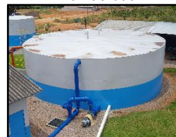
Figura 1313. Reservatório RAP-02 de 600 m³
