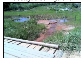
Figura 1404. Ponto de deságue sem galeria
