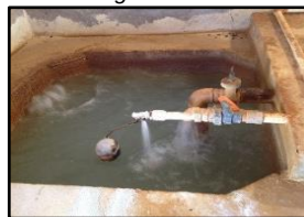
Figura 1437. Tanque de dosagem de coagulante na ETA
