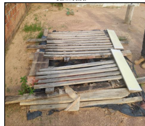
Figura 1399. Fossa instalada com tampa danificada
