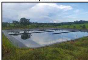
Figura 1337. Lagoa de maturação da ETE
