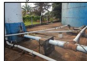
Figura 1297. Tubulação que interliga os reservatórios
