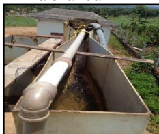
Figura 1413. Calha Parshall da ETA
