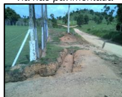
Figura 1403. Erosão em via não pavimentada
