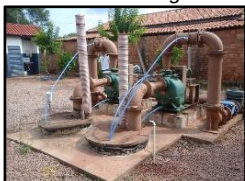
Figura 1377. Estação Elevatória de Esgoto 3
