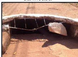
Figura 1445. Boca de lobo danificada
