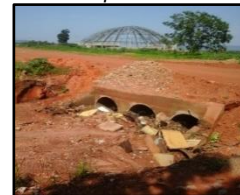
Figura 1385. Erosão em via não pavimentada
