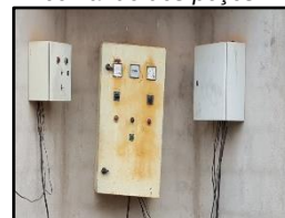
Figura 232. Quadro de comando dos poços
