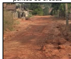
Figura 201. Via com pontos de erosão
