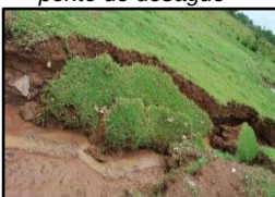
Figura 240. Erosão no ponto de deságue
