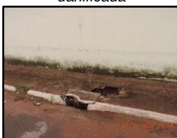
Figura 161. Boca de lobo danificada
