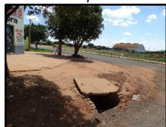
Figura 94. Boca de lobo inadequada
