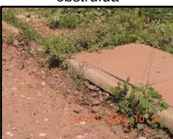
Figura 34. Boca de lobo obstruída
