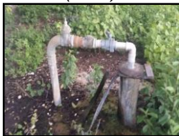
Figura 25. Poço tubular (PT-03)
