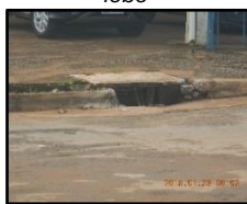
Figura 279. Boca de lobo
