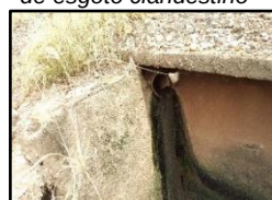
Figura 77. Lançamento de esgoto clandestino
