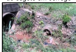
Figura 218. Lançamento de esgoto em córrego
