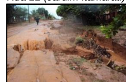
Figura 220. Erosão na Rua 11 (Jardim Itamarati)
