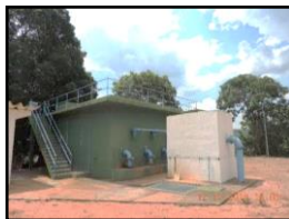
Figura 151. Vista da ETA Nortelândia
