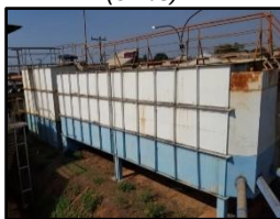
Figura 65. ETA metálica (32 l/s)
