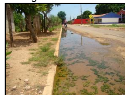
Figura 136. Rua com esgoto extravasado
