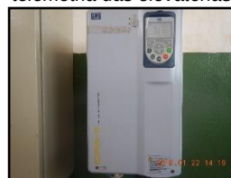
Figura 273. Painel de telemetria das elevatórias
