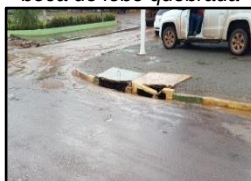
Figura 241. Entrada da boca de lobo quebrada
