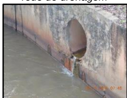
Figura 53. Deságue da rede de drenagem
