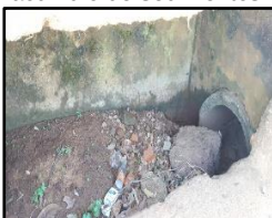
Figura 116. Galeria com acúmulo de sedimentos
