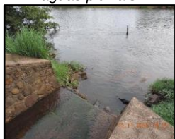
Figura 160. Deságue das águas pluviais
