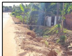
Figura 118. Processo erosivo na Av. Curitiba
