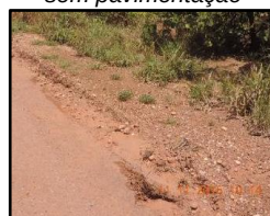
Figura 35. Erosão em via sem pavimentação
