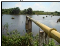
Figura 210. Captação no córrego do Mineiro
