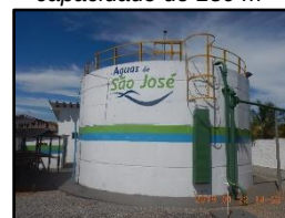
Figura 274. RAP-01 com capacidade de 150 m³
