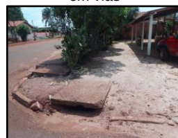
Figura 263. Bocas de lobo em vias
