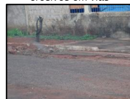
Figura 264. Processos erosivos em vias
