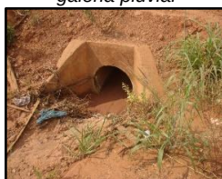
Figura 199. Deságue de galeria pluvial
