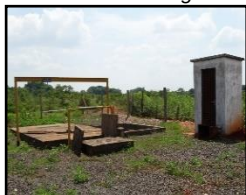
Figura 256. Estação Elevatória de Esgoto
