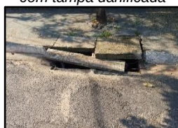
Figura 76. Boca de lobo com tampa danificada
