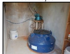
Figura 290. Sistema de desinfecção
