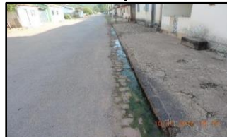
Figura 29. Lançamento de esgoto na sarjeta
