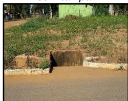
Figura 115. Boca de lobo sem tampa
