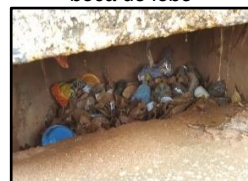
Figura 242. Resíduos na boca de lobo
