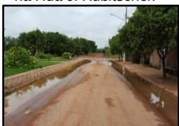
Figura 239. Alagamento na Rua J. Kubitschek
