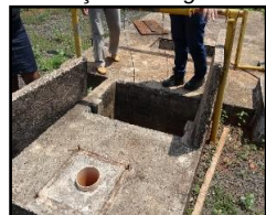
Figura 255. Poço de sucção de esgoto
