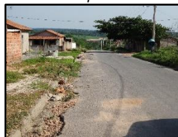
Figura 183. Via com erosão na parte lateral
