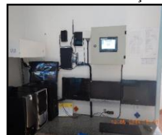
Figura 48. Painel do sistema de automação
