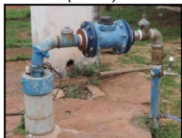
Figura 45. Poço Tubular (PT-01)
