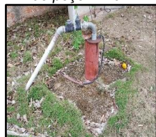
Figura 229. Barrilete do poço PT-02
