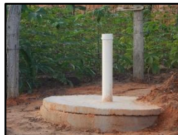
Figura 214. Vista externa da fossa rudimentar
