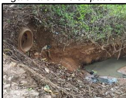
Figura 117. Deságue da galeria sem dissipador
