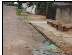
Figura 157. Esgotos lançados nas sarjetas
