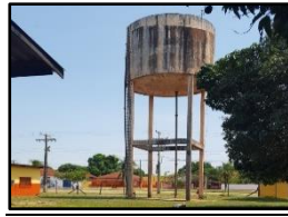
Figura 108. Reservatório REL-01 de 100 m³
