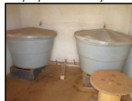
Figura 194. Tanque de preparo de solução
