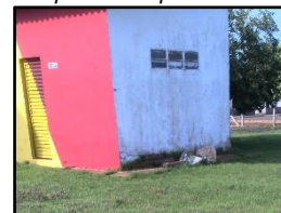
Figura 195. Casa de produtos químicos
