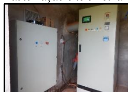
Figura 288. Sistema de automação e telemetria
