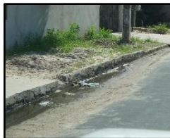
Figura 177. Escoamento a céu aberto
