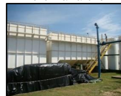
Figura 131. Vista da ETA Novo Diamantino
