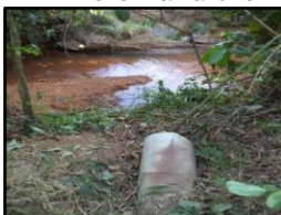
Figura 135. Emissário da ETE Novo Diamantino
