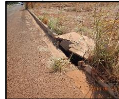
Figura 1774. Boca de lobo comprometida
