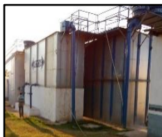
Figura 1744. Vista das duas ETAs metálicas
