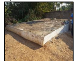
Figura 1843. Tanque-pulmão da EEE-01
