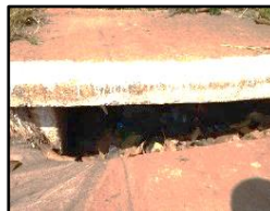
Figura 1755. Boca de lobo obstruída
