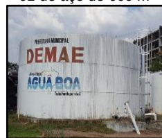
Figura 1723. Reservatório-01 de aço de 600 m³
