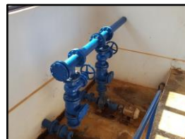
Figura 1840. Conjunto motobomba de 3 cv
