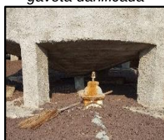
Figura 1727. Válvula de gaveta danificada
