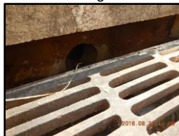
Figura 1773. Ligação clandestina de esgoto
