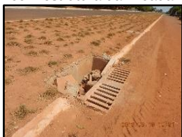
Figura 1806. Boca de lobo com estrutura danificada
