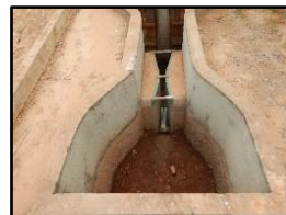
Figura 1825. Medidor de vazão da ETE
