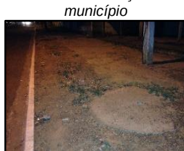
Figura 1750. Fossa rudimentar na calçada do município
