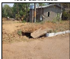
Figura 1731. Boca de lobo danificada
