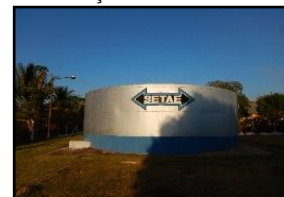
Figura 1746. Reservatório de aço de 300 m 3
