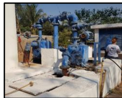
Figura 1842. Conjunto motobomba da EEE-01
