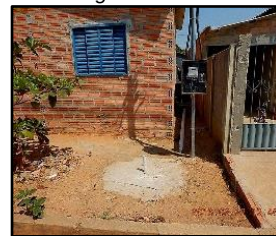
Figura 1770. Construção irregular de fossa
