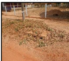
Figura 1807. Boca de lobo obstruída
