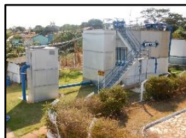
Figura 1745. Vista das duas ETAs metálicas
