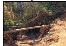
Figura 1756. Erosão ao longo do córrego Voadeira
