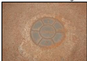
Figura 1824. Poço de visita da rede coletora de esgoto
