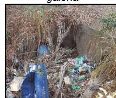
Figura 1733. Deságue da galeria
