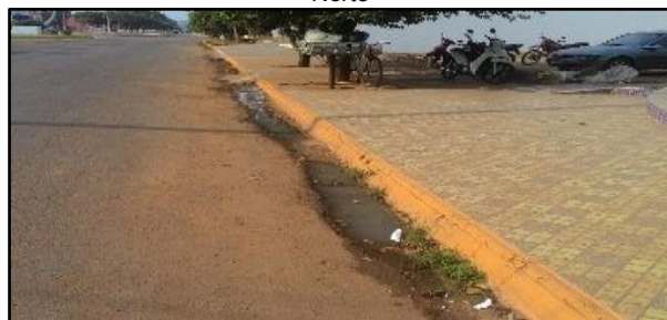
Figura 1804. Escoamento de esgoto a céu aberto em Gaúcha do Norte
