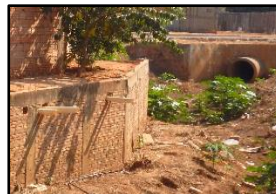
Figura 1868. Rede de esgoto clandestina
