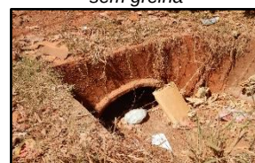
Figura 1888. Boca de lobo sem grelha
