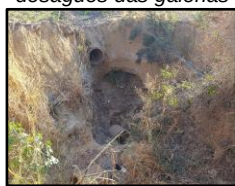
Figura 1848. Erosão nos deságues das galerias
