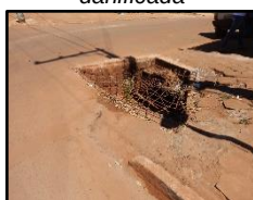
Figura 1886. Boca de lobo danificada
